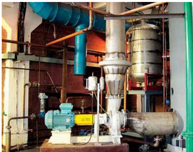
Насос циркуляции барды через кипятильник бражной колонны
